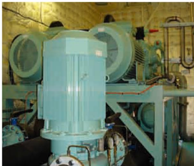
カーゴタンク冷却装置
