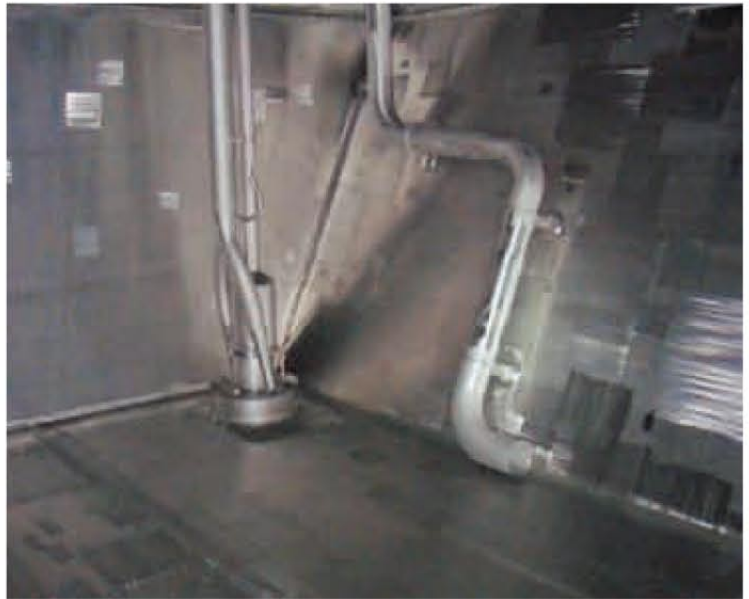
カーゴタンク内部
